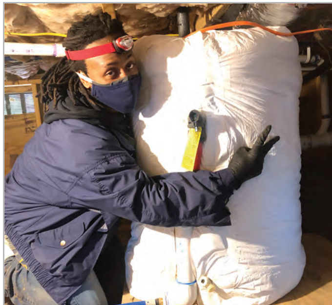
Daniel, sintiéndose feliz después de ponerle aislamiento a este tanque de agua.
